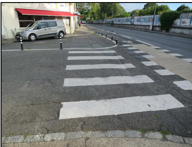
Réduction du rayon de giration et raccourcissement de la traversée avec des potelets (Tours)
