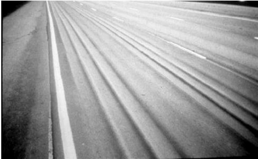
Gambar 1.3. Kerusakan jalan berupa alur roda (rutting) [4]
