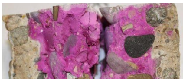
©setec LERM. Carbonatation d'un béton (zone non colorée). Test à la phénolphthaléine
