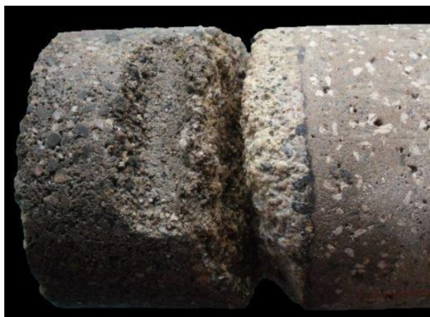
©lerm. Carotte composée de deux bétons distincts, décollés. Face externe (à gauche) et face interne (à droite) de la cheminée
